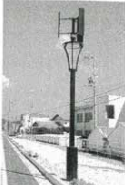
エコ・フアンチャーは照明部分上部に風力発電装置と太陽光パネルを備える。風力発電装置は長さ約1000ミリ、幅250ミリのフレッド3枚を持つツヤイロミル型。フレッドは自動車部品で培ったアルミニウム成形技術を生かし、1枚板を鋭角にカーブさせ回転効率を高めた。さらに太陽光発電との併用により「ほとんど日照時間がなく、無風状態が続いても蓄電で5~10日間は点灯する」(有馬社長)という。
